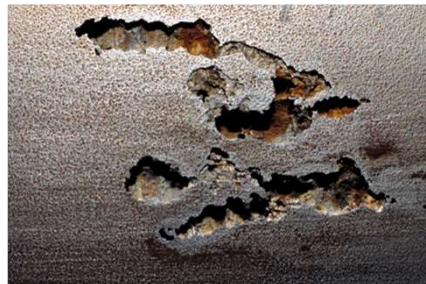
Grubetæring i 4307-rør (udefra). Røret har været brugt som "sugerør" i brøndvand
